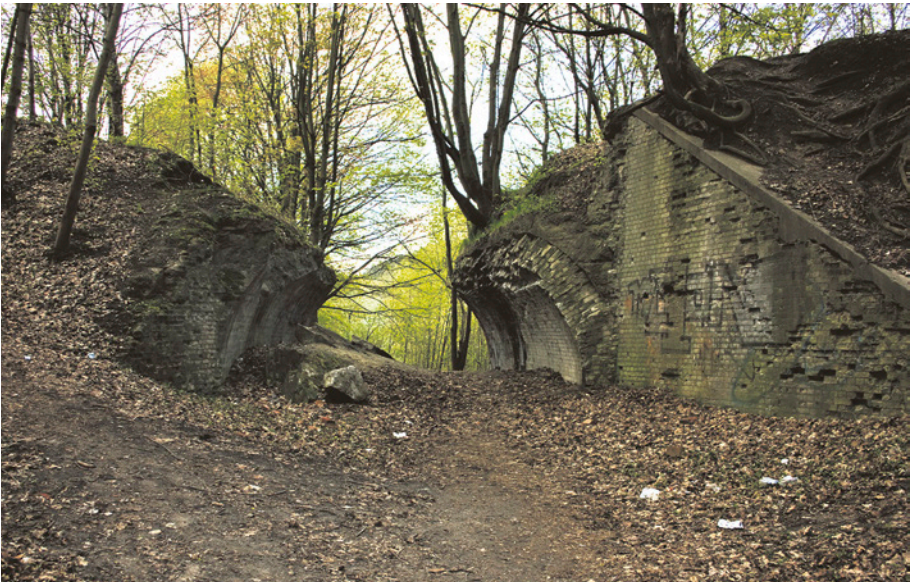
[12b] Przepust drogi z Brętowa do Srebrzyska. Duże osunięcie konstrukcji łuku z lewej strony powstało w latach 70. xx w. Widok od strony wschodniej w kierunku Brętowa. 5.05.2010 r.
