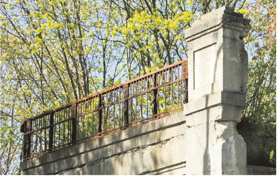
[5c] Ukradziona ok. 20 lutego 2013 r. metalowa barierka zachodniego przyczółka wiaduktu nad ul. Polanki. Widok od strony południowej. 5.05.2010 r. FOT. HENRYK JURSZ
