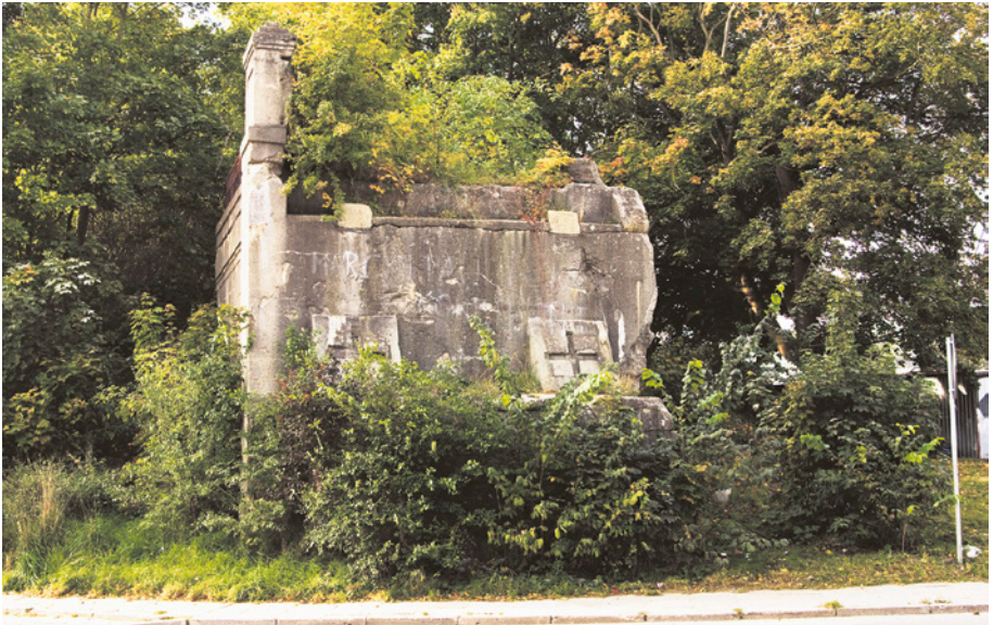
[5b] Zachodni przyczółek wiaduktu nad ul. Polanki z zachowanym południowym fragmentem ozdobnej metalowej barierki (została skradziona ok. 20 lutego 2013 r.). Widok od strony wschodniej. 8.10.2010 r.
