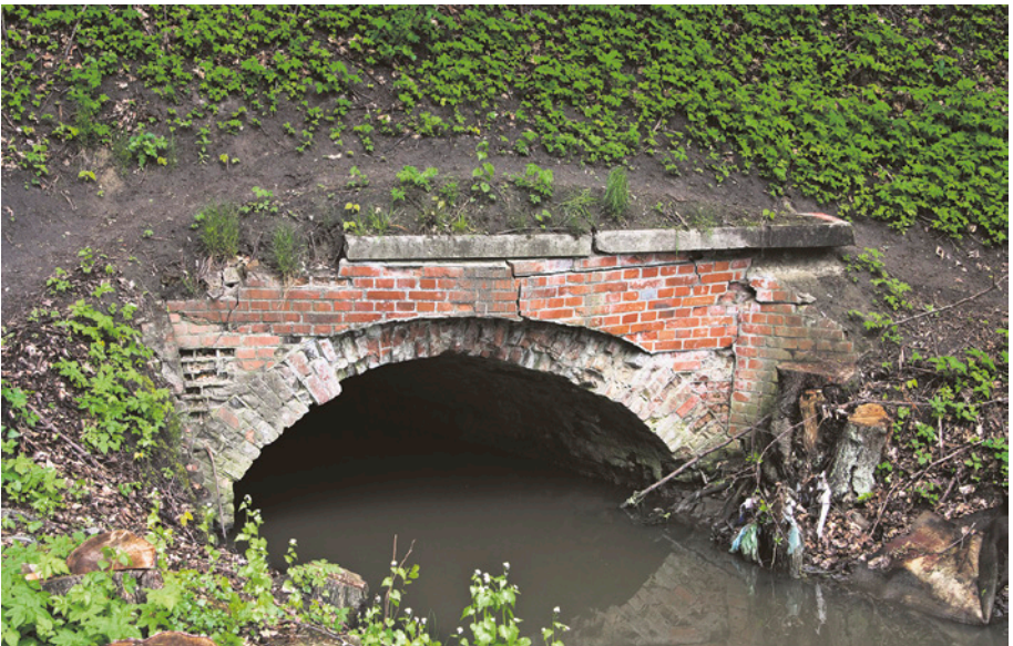
[11b] Przepust potoku Strzyży pod nasypem linii kolejowej z Gdańska Wrzeszcza do Starej Pily w Brętowie. Widoczne pęknięcia i ubytki cegieł. Widok od strony wschodniej. 21.05.2011 r.
