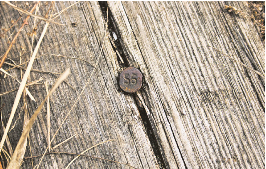
[32b] Podkłady toru do Kiełpinka, po II wojnie światowej bocznicą do bazy magazynowej CPN, datowane są na lata 1955–1956. Prawdopodobnie w tych latach odbudowano odcinek Kokoszki – Kiełpinek. 30.04.2010 r.
