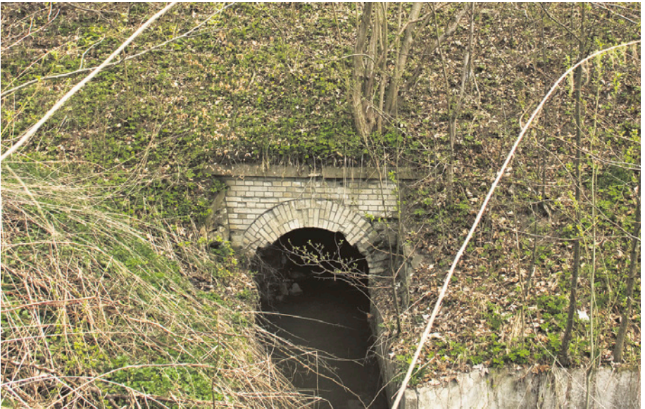
[29b] Przepust strumienia pod nasypem kolejowym w Karczemkach. W okresie międzywojennym w pobliżu przebiegała granica polsko-gdańska. Widok od strony południowej. 30.04.2010 r.
