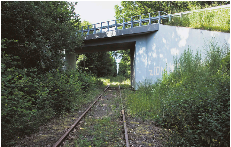
[35a] Wyremontowany w 2008 r. wiadukt drogowy w ciągu ul. Bysewskiej. Widok od strony północnej. 8.07.2010 r.
