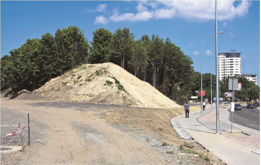
[10a] Po wyburzonym w 2006 r. północnym przyczółku wiaduktu nad ul. Słowackiego nic nie zostało. Widok od strony zachodniej. 20.05.2012 r.
