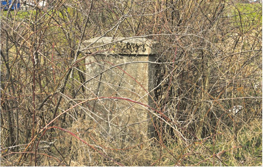
[30a] Po północnym przyczółku wiaduktu łączącego dzisiejsze ulice Dojazdową i Osiedlową zostało niewiele. 30.04.2010 r.
