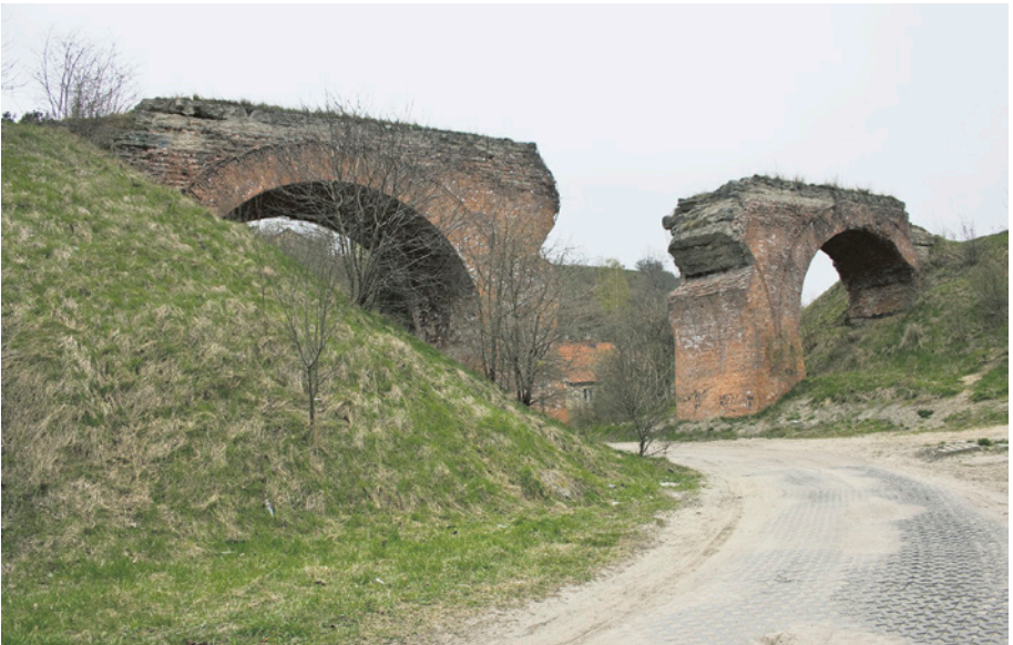
[18b] Wiadukt nad ul. Dolne Migowo przez amatorów wspinaczki jest nazywany Łuki. To jeden z najbardziej urokliwych obiektów dawnej kolei. Widok od strony południowej. 28.04.2010 r.
