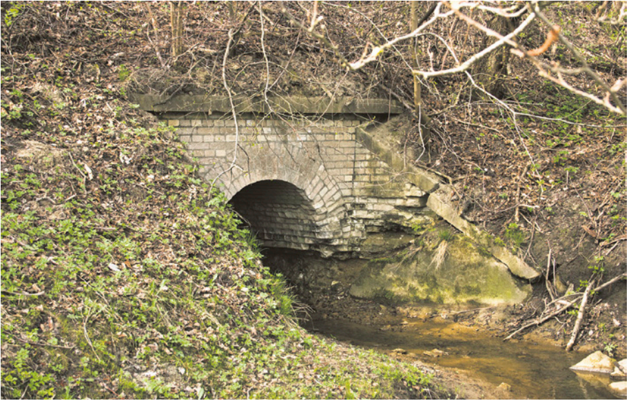
[29a] Przepust strumienia pod nasypem kolejowym w Karczemkach. Widok od strony północnej. 30.04.2010 r.
