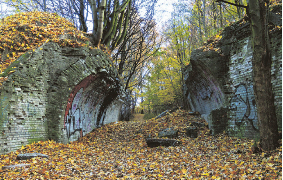
[12a] Przepust drogi z Brętowa do Srebrzyska nazywany przez amatorów wspinaczki Przewieszki. Widok od strony zachodniej. 3.11.2009 r.
