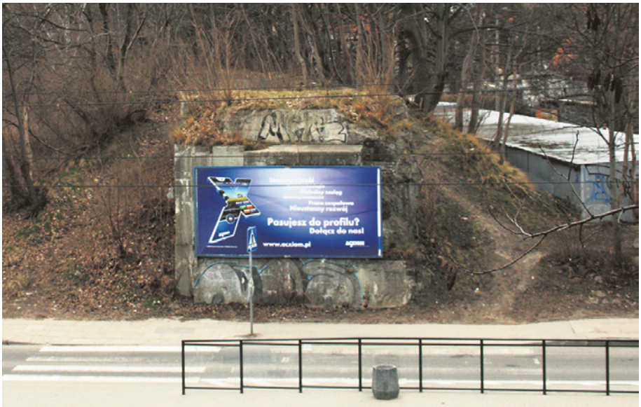
[4b] Także zachodni przyczółek nieistniejącego wiaduktu kolejowego nad ul. Wita Stwosza wykorzystywany jest do zawieszania reklam. Widok z przyczółka wschodniego. 7.04.2010 r. FOT. HENRYK JURSZ
