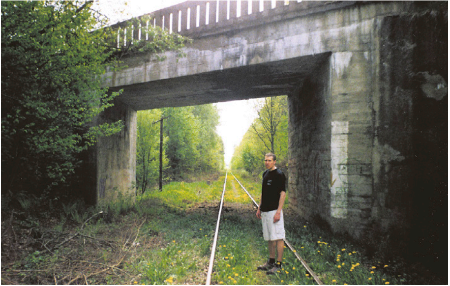
Wiadukt w ciągu ul. Bysewskiej przed remontem. Widok w kierunku stacji w Leźnie. Wiosna 2003 r.
