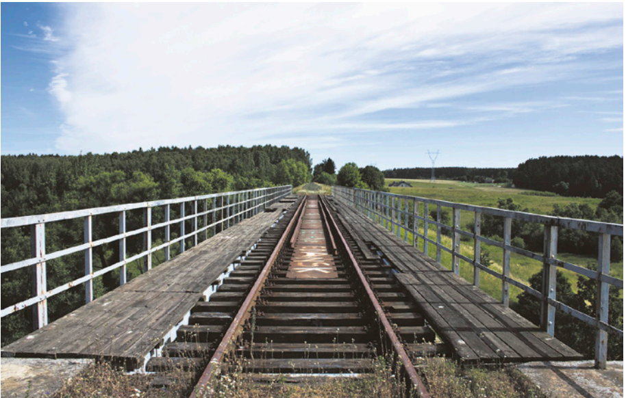
[41a] Most kolejowy nad rzeką Radunią pomiędzy stacjami w Leźnie i Starej Pile. W 1945 r. został wysadzony, a w 1950 r. odbudowany. Widok w kierunku północnym. 8.07.2010 r.
