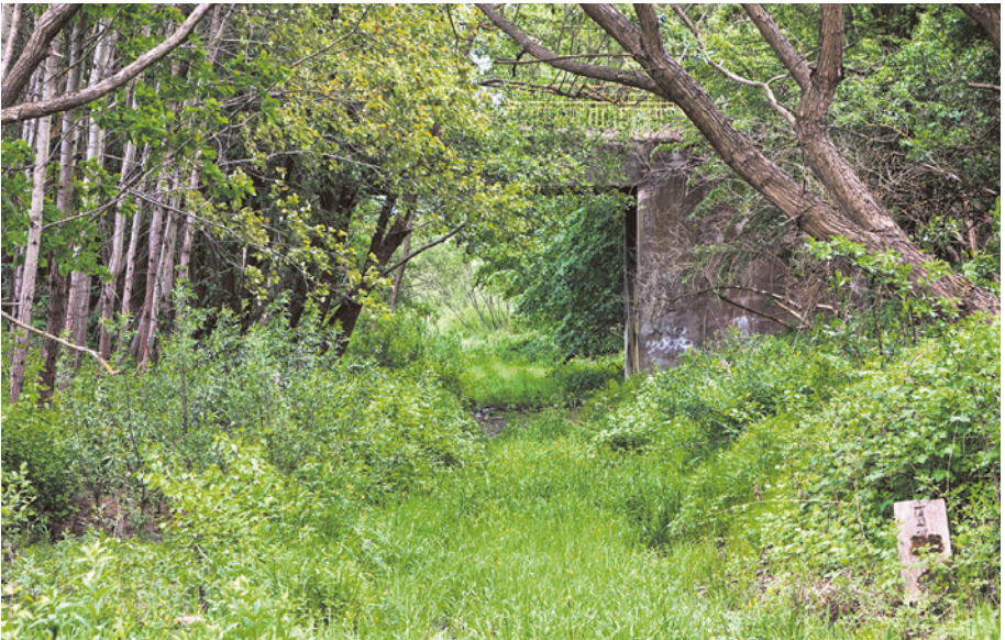
[27b] Wiadukt w ciągu ul. Szczęśliwej. Po jego szerokości można stwierdzić, że i tu linia przygotowana była do przebudowy na dwutorową. Widok od strony zachodniej w kierunku Migowa. 26.05.2012 r. FOT. HENRYK JURSZ
