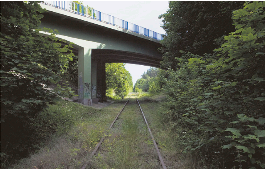
[36b] Wiadukt drogowy w ciągu drogi z Gdańska do Żukowa. W 1914 r. opisywany w prasie jako wyjątkowa ukośna konstrukcja. Widok od strony południowej w kierunku Kokoszek. 8.07.2010 r.
