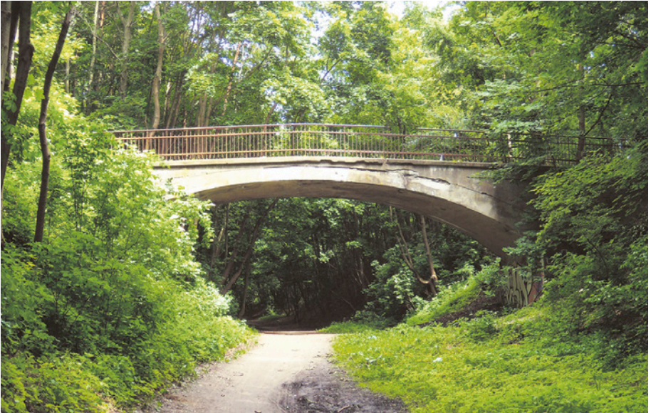
[8a] Wiadukt nad dawnym torowiskiem w przedłużeniu ul. Ludowej. Widok w kierunku północno-wschodnim. 22.06.2009 r.
