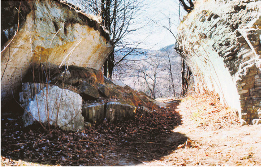
Zniszczony w czasie II wojny światowej przepust drogi z Brętowa do Srebrzyska. Widok w kierunku zachodnim. 1975 r.
