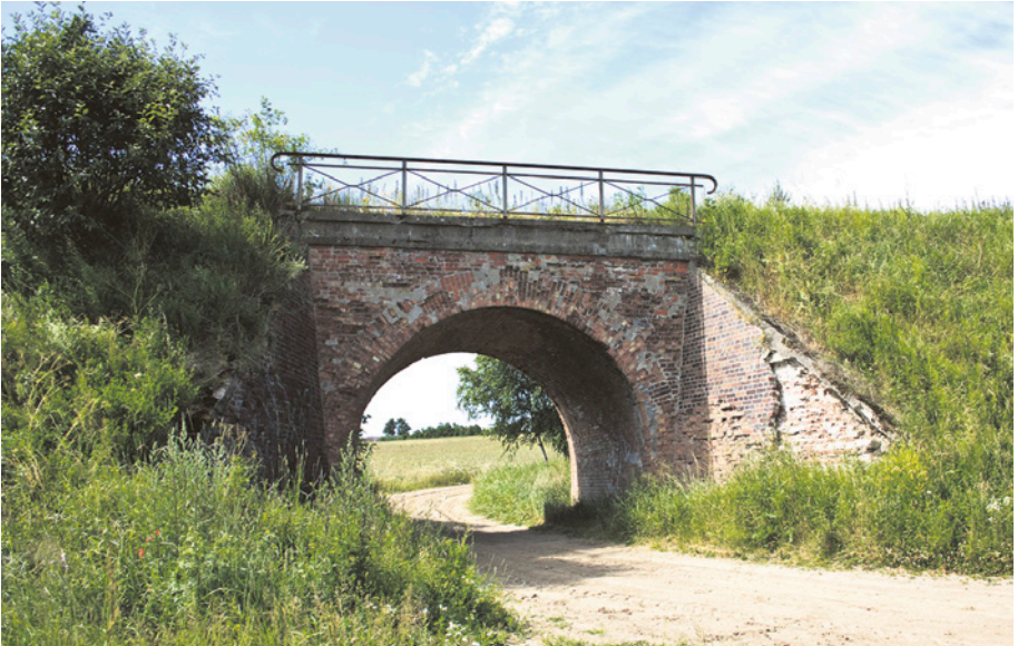
[42a] Wiadukt kolejowy nad polną drogą w okolicach Niestępowa i Starej Piły. Widok od strony północnej. 8.07.2010 r.
