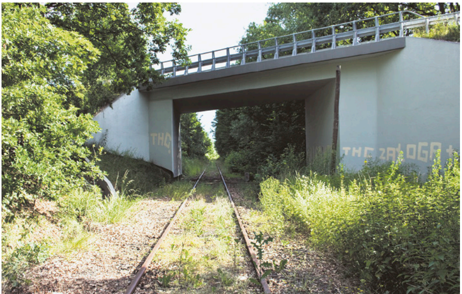
[35b] Wiadukt drogowy w ciągu ul. Bysewskiej. Tu również widoczne jest miejsce na planowaną rozbudowę linii kolejowej o drugi tor. Widok od strony południowej w kierunku Kokoszek. 8.07.2010 r.
