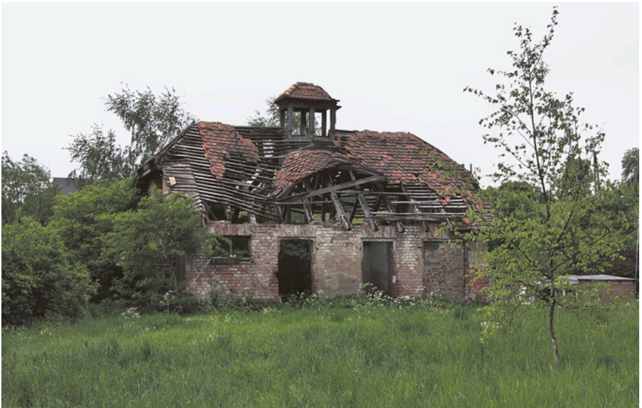
[25b] Budynek stacyjnej toalety na dawnym przystanku kolejowym w Kietpinks jest w zasadzie ruiną. Niezabezpieczony niszczeje z dnia na dzień. Widok od strony północnej. 21.05.2011 r. FOT. HENRYK JURSZ
