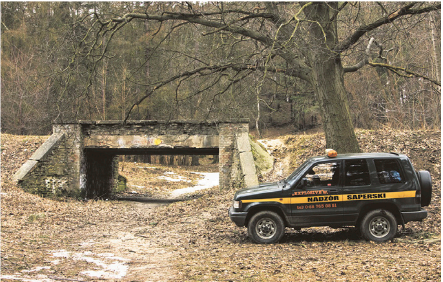
[7b] Przepust drogi na przedłużeniu ul. Kiepury. Na początku 2011 r. na zlecenie firmy PKM SA saperzy sprawdzili odcinek Wrzeszcz – Kiepiniek dawnej kolei. Widok od strony wschodniej. 10.02.2011 r. FOT. HENRYK JURSZ
