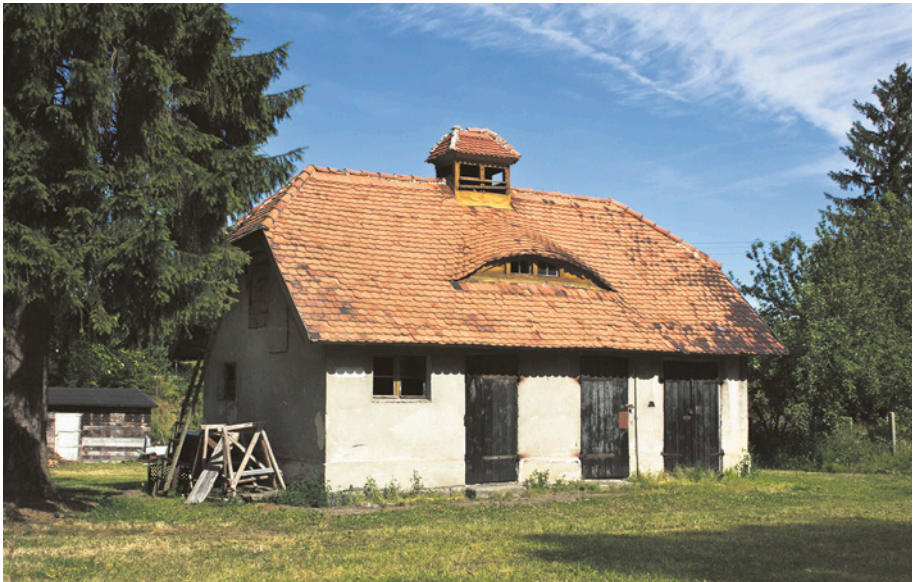
[37b] Dawne dworcowe toalety, choć pełnią już zupełnie inne funkcje, są w znakomitym, jak na blisko stuletnią konstrukcję, stanie. Widok od torów i peronu (strona wschodnia). 8.07.2010 r. FOT. HENRYK JURSZ
