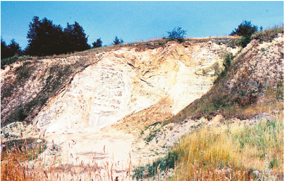
Uszkodzenie nasypu spowodowane wybieraniem żwiru przez mieszkańców w pobliżu rozebranego w latach 70. xx w. wiaduktu nad ul. Rakoczego. Widok od strony Brętowa. 1975 r.
