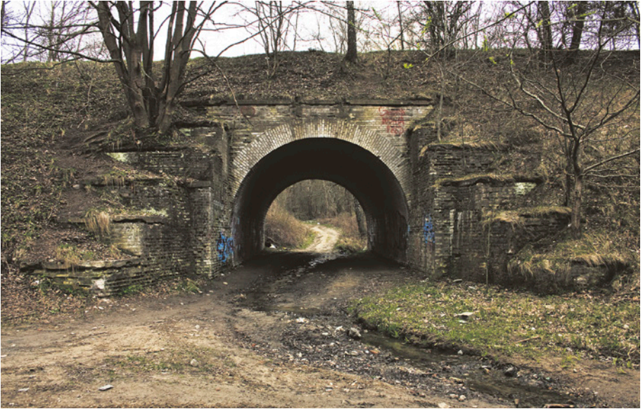
[21a] Wiadukt nad ul. Wołkowyską. Charakterystyczne schodkowanie miało służyć rozbudowie kolei o drugi tor. Widok od strony północnej. 28.04.2010 r. FOT. HENRYK JURSZ
